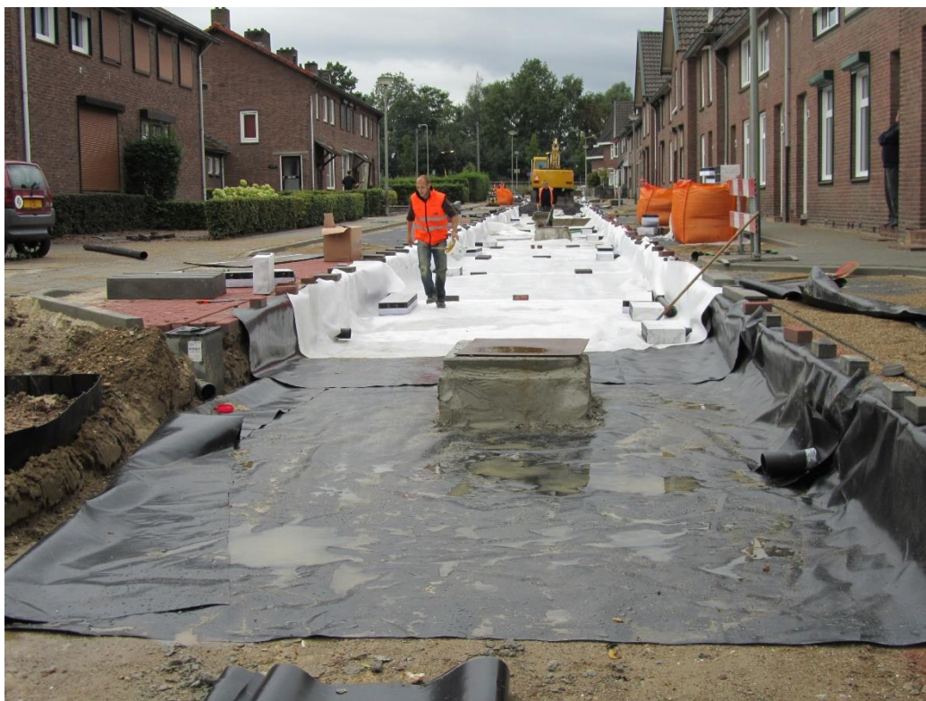
Figuur 2-5: Bergend systeem (folie onderin het cunet) met hulpstukken voor het aansluiten van kolken en daken
