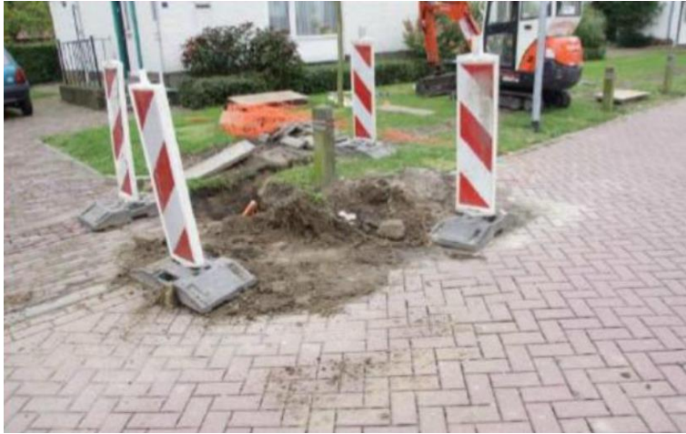
Figuur 6-3: Vervuiling van de verharding door werkzaamheden
